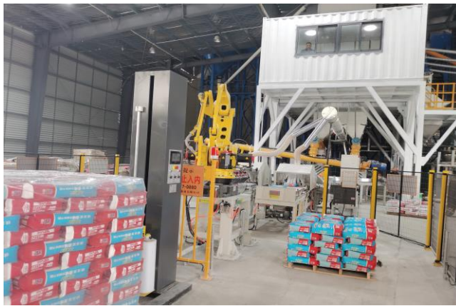
图 3-5 废气处理设施（收集装置）
