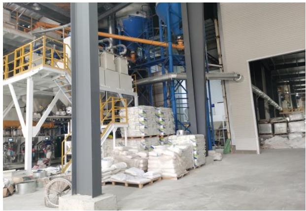
图 3-6 废气处理设施(袋式除尘器)
